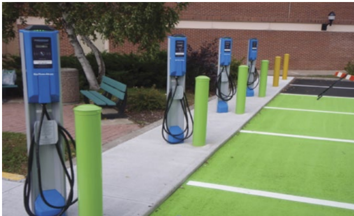
Bornes de recharge d'AddÉnergie
