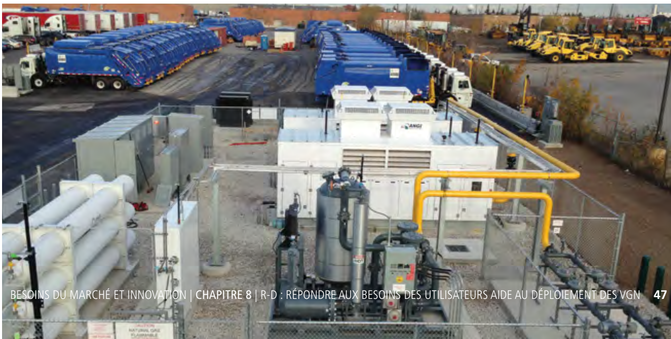
U.S. Gain-Emterra Mississauga, Ont. – Les plus vastes installations de ravitaillement de GNC au Canada
