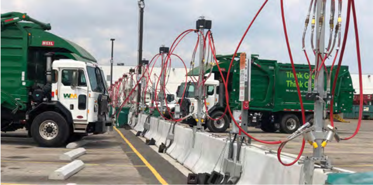
Installations de traitement des déchets de Stony Creek, Ont., construites par ComTech Energy
